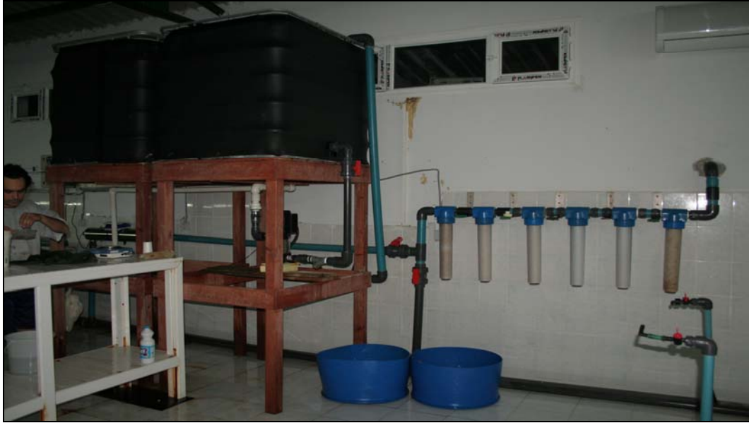
Şekil 5. Araştırma İstasyonumuzda kuluçkahane içerisinde bulunan kartuş filtreler ve ısıtma/soğutma sisteminin aksamaları.
